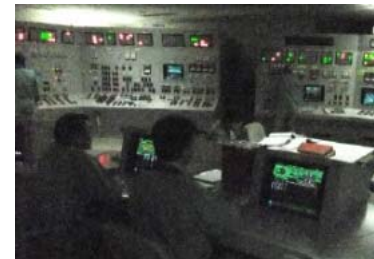
シミュレータ訓練 （全交流電源喪失対応）
