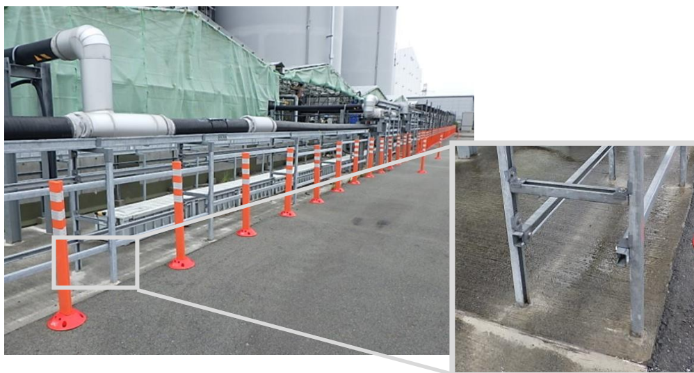
(a) 移送配管のサポートの現場での施工例と固定状況
