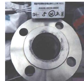
フランジ腐食面
