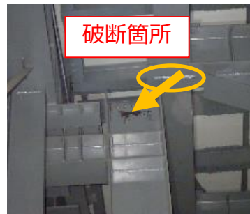
【写真③】 間柱破断した箇所 (内側から撮影)
