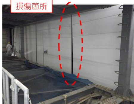
【写真②】 損傷を確認した外壁 (外側から撮影)
