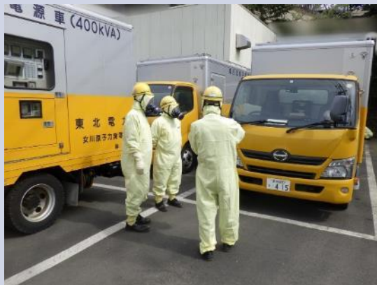
高圧発電機車始動前点検
