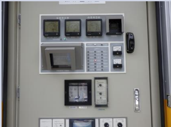
電源車非常停止 (マルファンクション)
