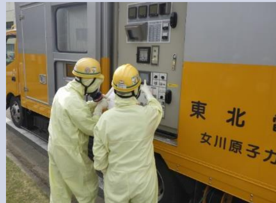
電源車非常停止後の状態確認
