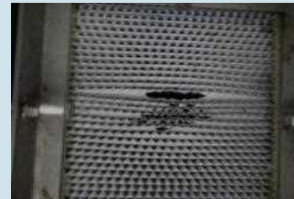
損傷した排気フィルタ
