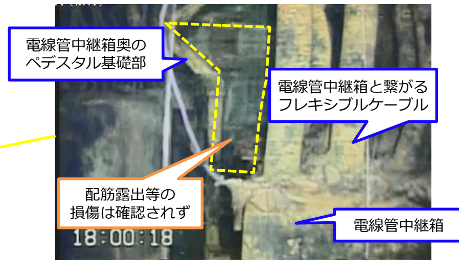
写真1.中継箱奥ペDESTAL壁面(堆積物上部)
