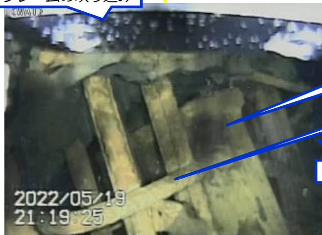
写真1.ペDESTAL開口部(左側基礎部)の状況
