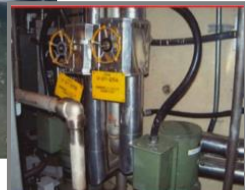
写真1.機器ドレンサンプポンプ付近の状況
