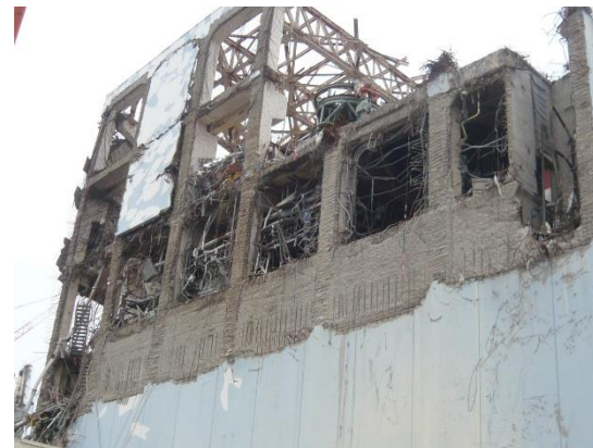
参考 4号機R/Bの損傷状況
