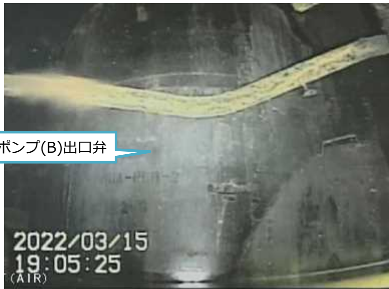
写真1. PLRポンプ(B)出口弁付近の状況
