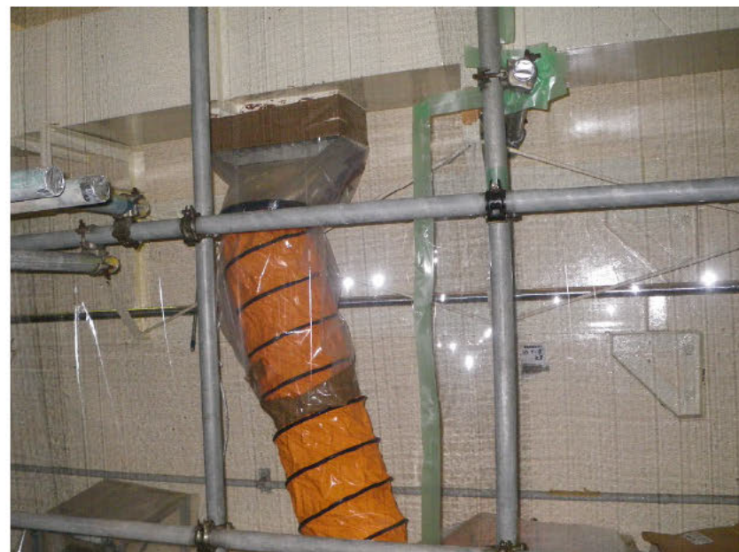
図3 建家換気ダクトと仮設排気ダクトの接続状態
