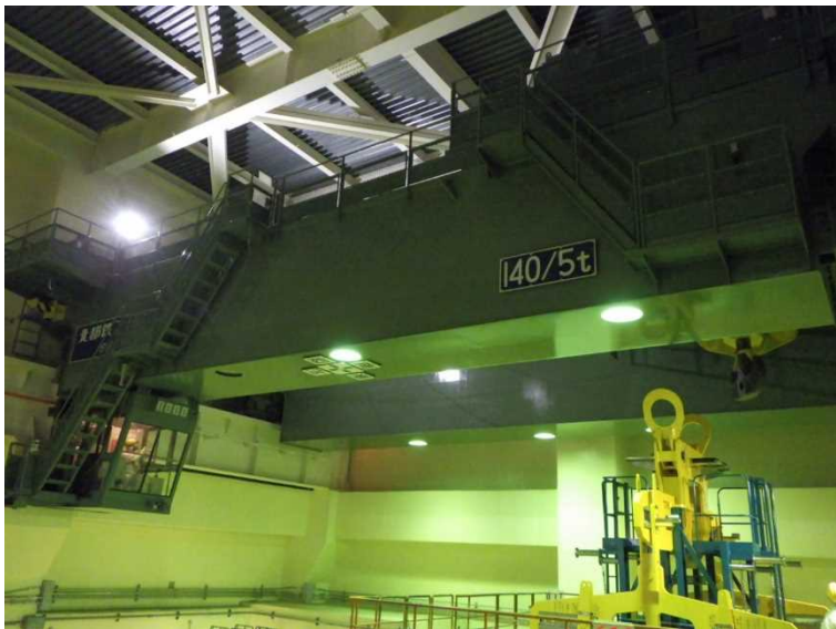
キャスク搬出入エリア天井クレーン
