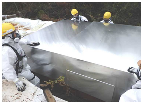
金属製カバー設置状況
