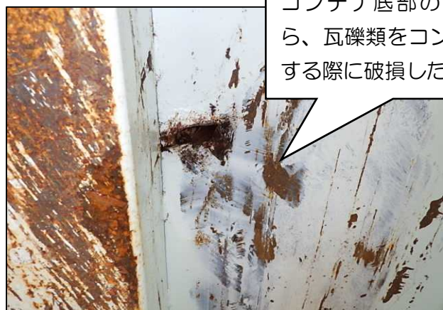
コンテナ3（補修前）
