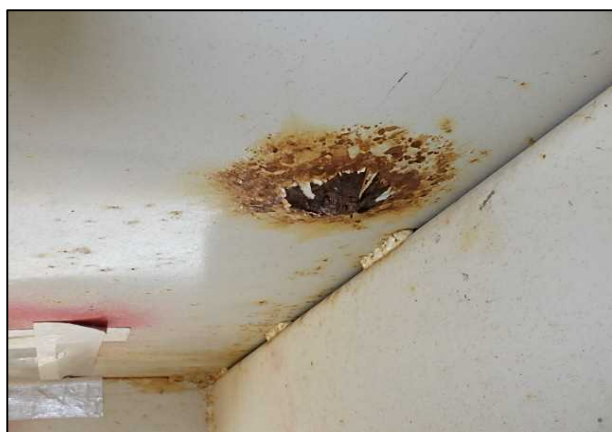
コンテナ2（補修前）
