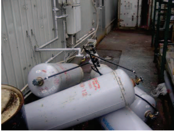
東日本大震災でのLPガスボンベの被災状況の一例 3)
