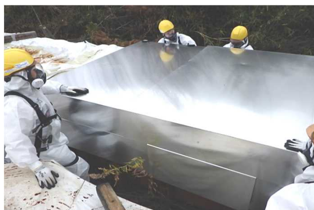
当該ノッチタンクは金属製のカバー を設置し耐候性シート養生済
