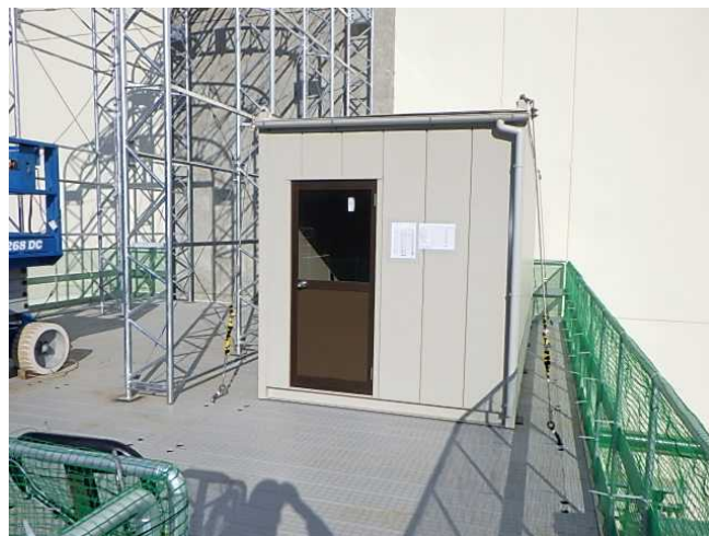
② 装備交換所 (設置完了)
