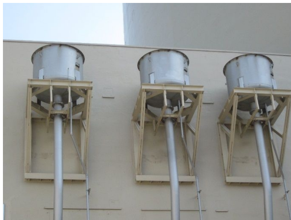
図3 主蒸気逃がし弁消音器の設置状況
