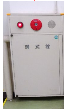
屋内消火栓設備
