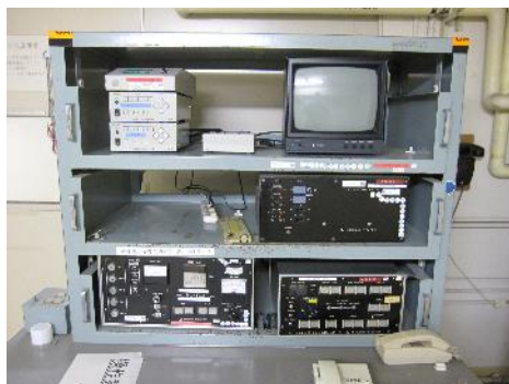
ライナック操作盤 (撤去)
