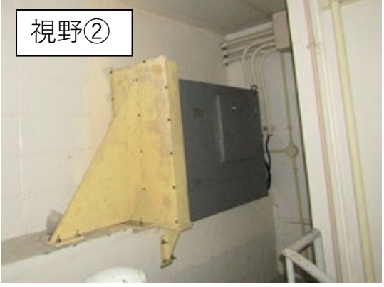
フィルム交換装置 (ラジオグラフィーフイルム交換室内)
