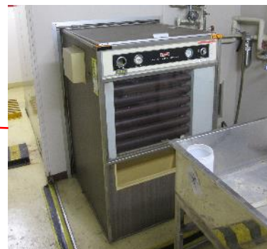
自動現像機 (撤去)
