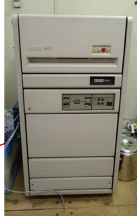
操作盤 (電源盤) (撤去)
