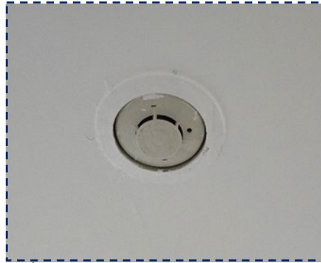
感知器 (自動火災報知設備)
