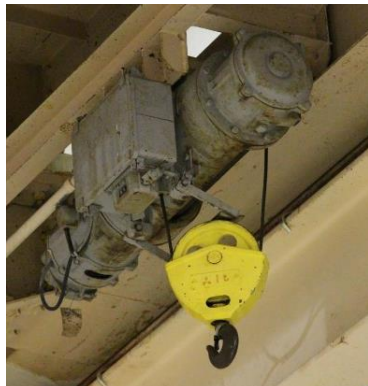
クレーン設備
