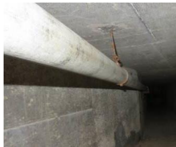
撤去対象廃液輸送管
