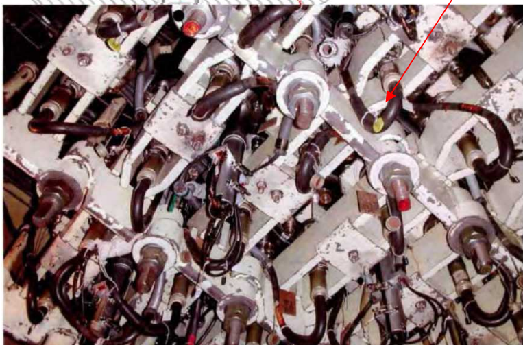
震災前のCRDハウジング支持金具の状態 (3号機)
