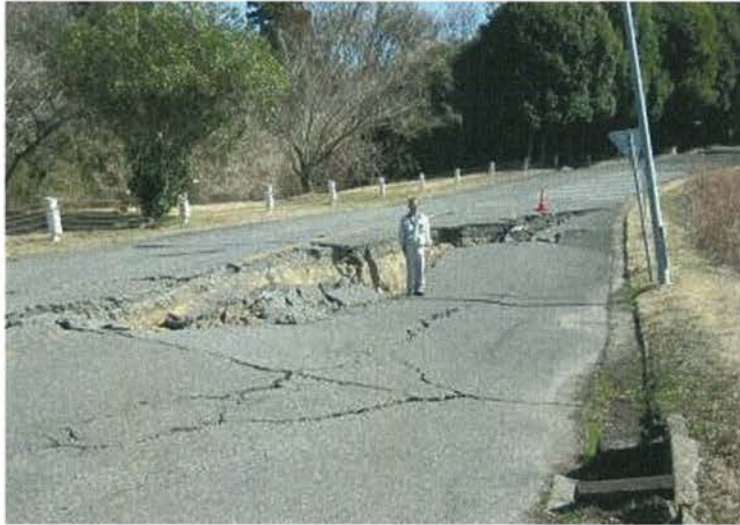
図-4 2011年東北地方太平洋沖地震の被害状況（図-2 ⑬構内道路付近）
