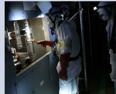
切替盤作業(SBO下想定)
