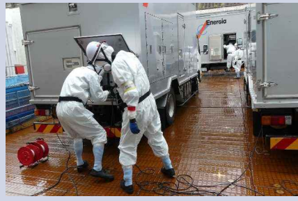
高圧発電機車始動前点検
