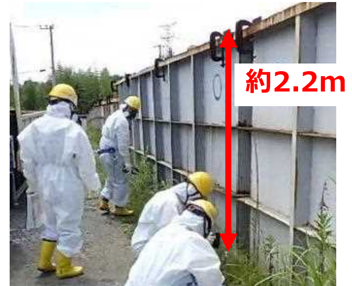
<ノッチタンクの設置状況>
