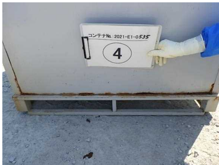
写真1.側面下部に著しい腐食があるコンテナ (E1エリア,6月9日撮影)
