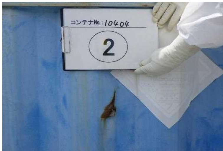
写真5.側面に著しい腐食があるコンテナ (貫通有るが水漏れ無し)(E1エリア, 5月3日撮影)
