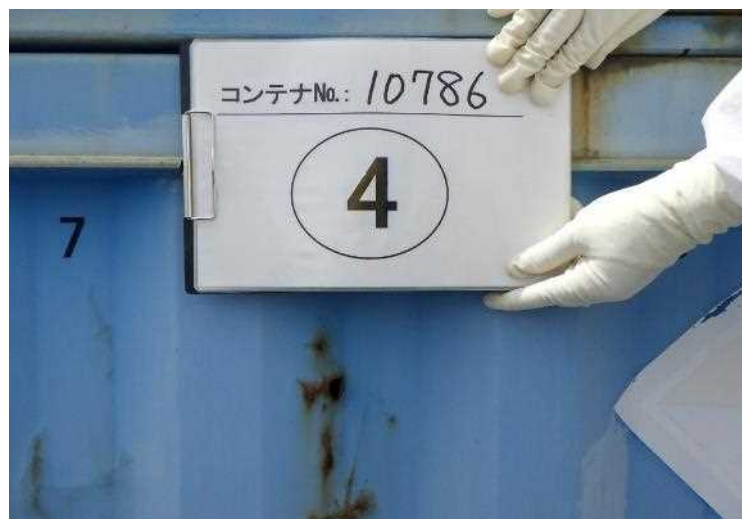
写真7.側面に著しい腐食があるコンテナ (貫通有るが水漏れ無し)(E1エリア, 5月3日撮影)
