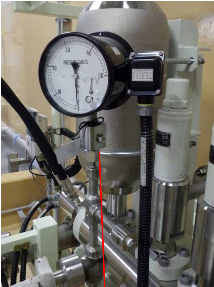
圧力計（PIO-11）：高圧水ポンプ吐出圧力
