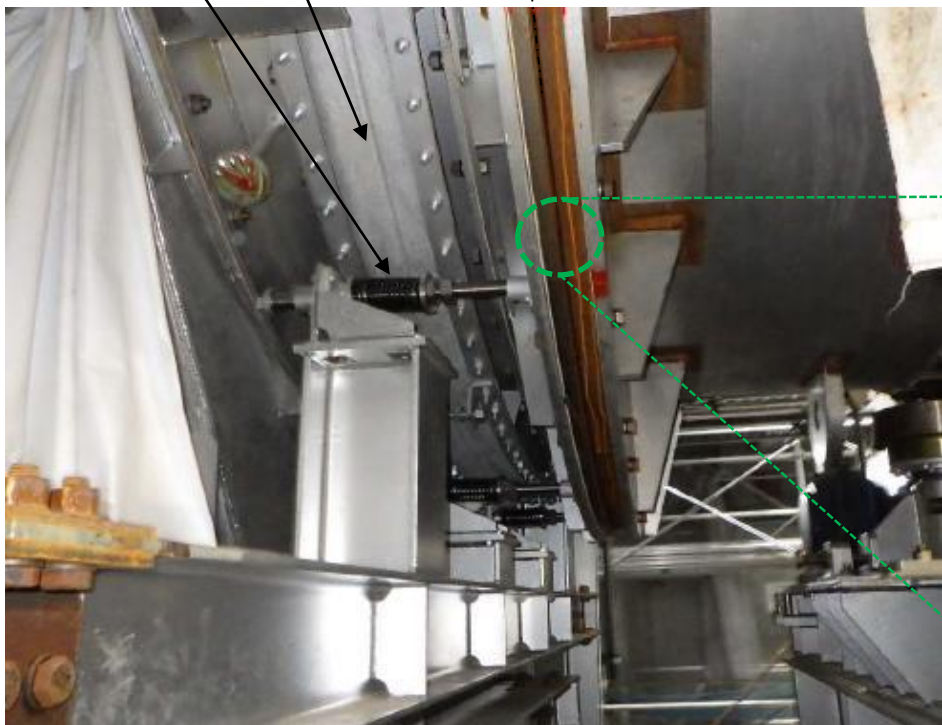
ロータリーキルン シール部 (入口側)
