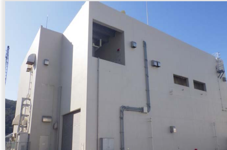
非常用ガスタービン発電機設備
