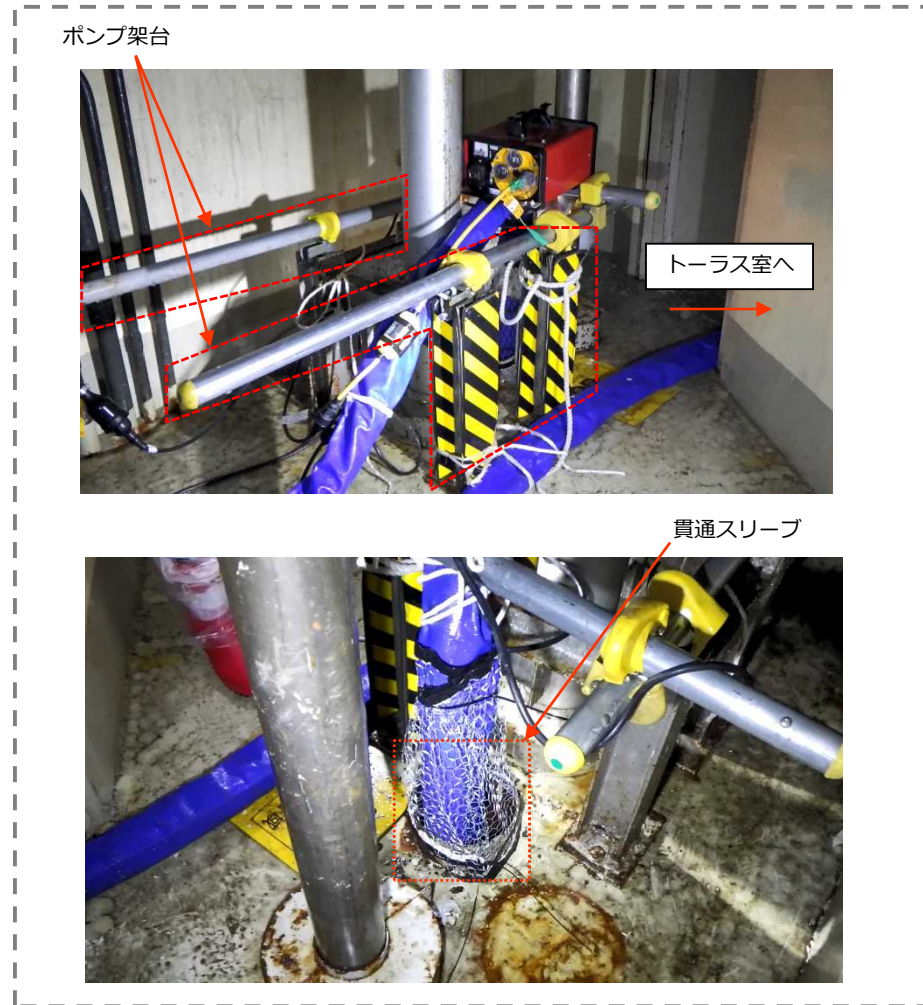
仮設排水設備状況写真
