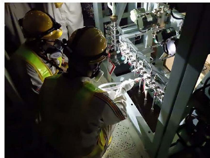
受入槽等への直接給水(遅延対策①)(各班毎に実施)
