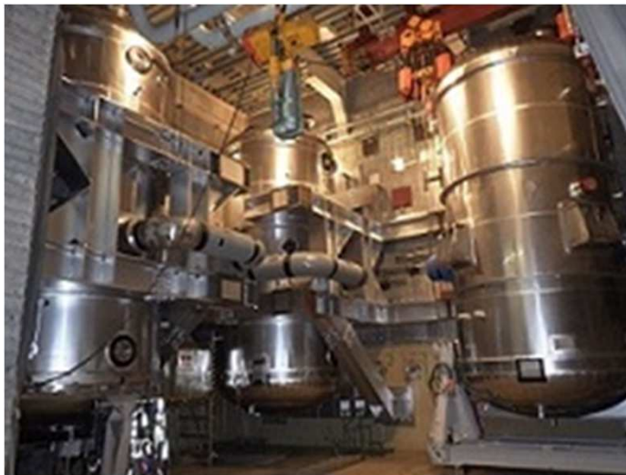
フィルタ付格納容器ベント装置
