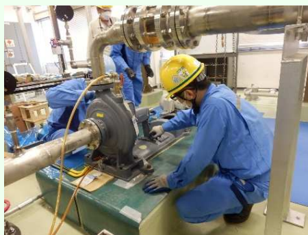
ポンプ分解・組立訓練
