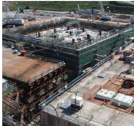
緊急時対策所
