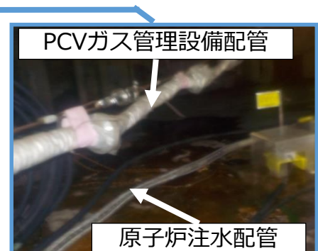
移設対象の重要設備
