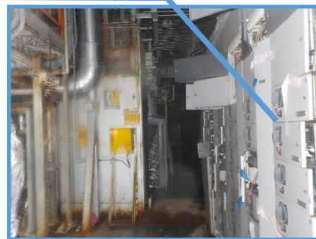
電源盤等の干渉物
