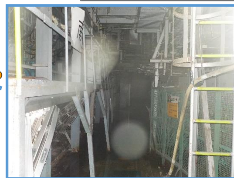
原子炉建屋1階の重要設備及び搬入経路確保に伴う干渉物写真
