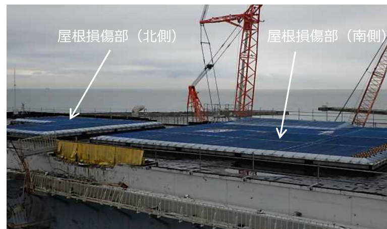
屋根状況【流入防止堰・雨水カバー設置完了】 〔西側から撮影〕
