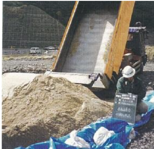
埋戻土(購入土) 現地写真(H11年)
