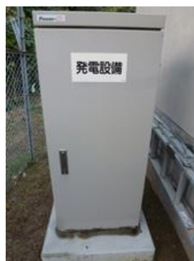
(非常用発電機の写真)
