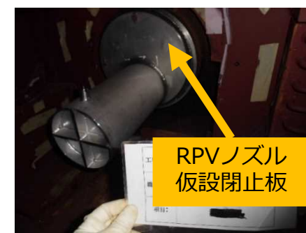
4号機RPVノズルの仮設閉止状況
