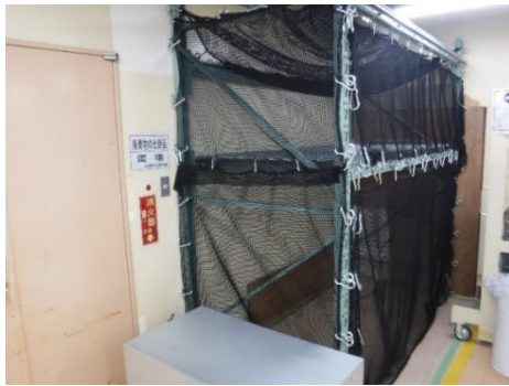
・低放射性固体廃棄物は、保管棚内に保管 (1階の保管棚は、津波による流出防止のためのネット設置済)
