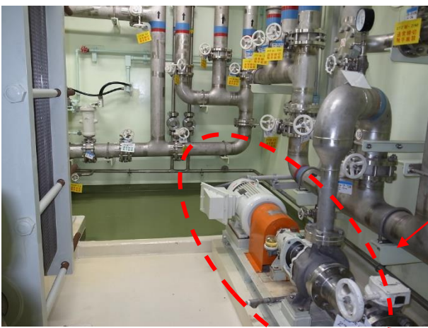
防護対象機器 (一次冷却水ポンプ)
