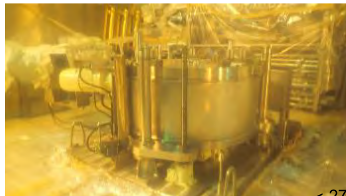
遠隔交換装置全景
