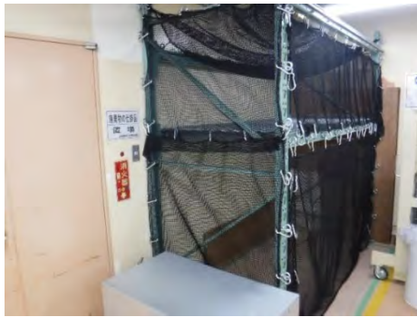
・低放射性固体廃棄物は、保管棚内に保管 (1階の保管棚は、津波による流出防止のためのネット設置済)
