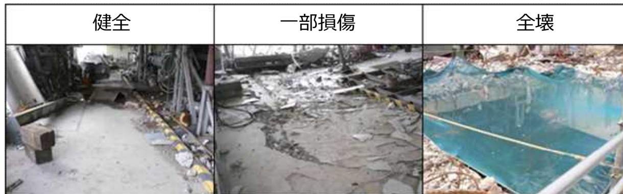
損傷度分類の例
