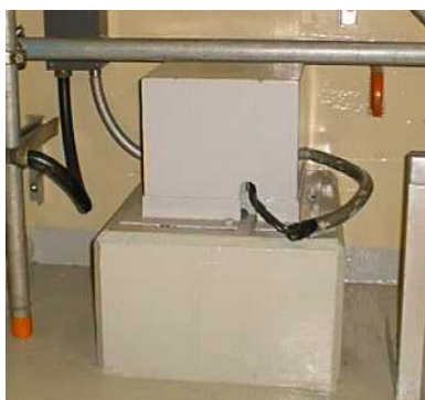
6号機の既設地震計
