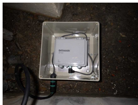
3号機に設置した地震計 (1階レベル)
