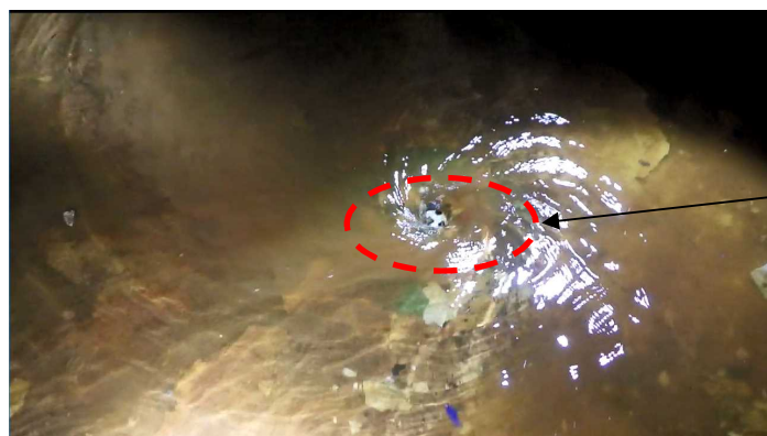
床ファンネル（清掃前）
