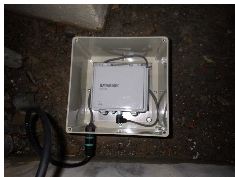
3号機に設置した地震計 (1階レベル)
