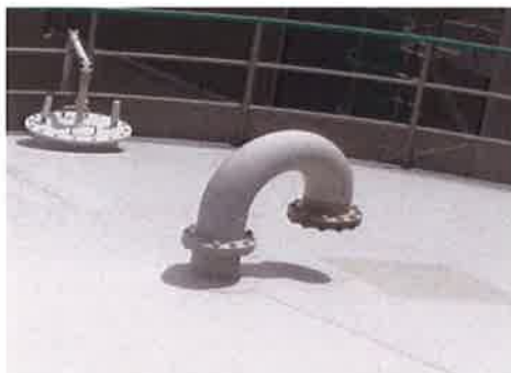
図5 復水タンクベント管
