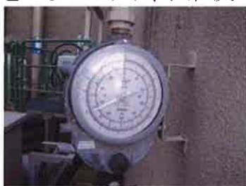
図4 復水タンク水位計
