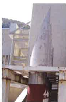
図 3 主蒸気安全弁（排気管）の設置状況（3号炉）
