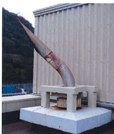
図 1 タービン動補助給水ポンプ蒸気大気放出管の設置状況
