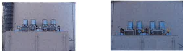
図 3 主蒸気逃がし弁消音器の設置状況 (左 3号炉、右 4号炉)
