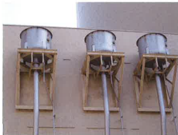
図3 主蒸気逃がし弁消音器の設置状況
