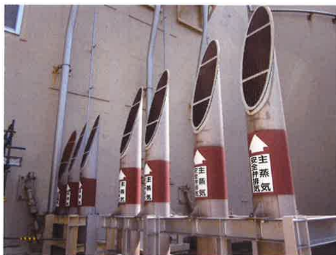
図3 主蒸気安全弁（排気管）の設置状況
