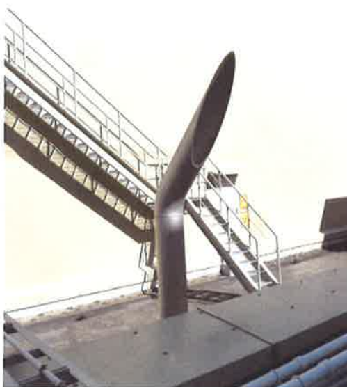
図 1 タービン動補助給水ポンプ蒸気大気放出管の設置状況
