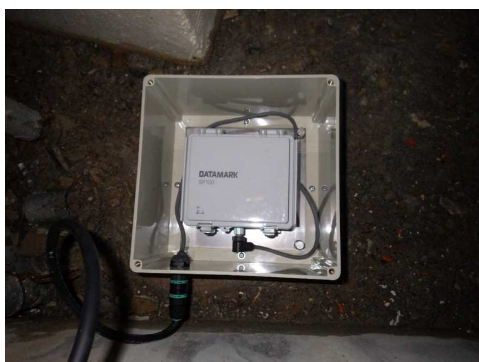
3号機に試験設置した地震計※ (1階レベル)
