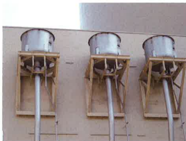
図 3 主蒸気逃がし弁消音器の設置状況
