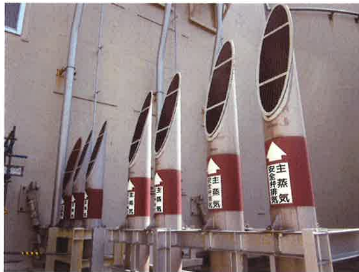
図3 主蒸気安全弁（排気管）の設置状況
