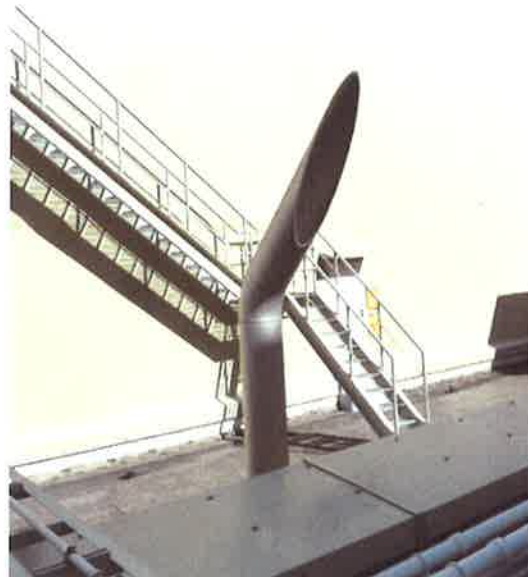
図 1 タービン動補助給水ポンプ蒸気大気放出管の設置状況
