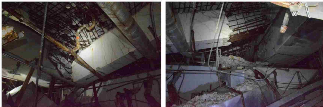
図2 3号機原子炉建屋3階天井部の小梁の損傷状況 (2019年12月の現地調査において確認されたもの)
