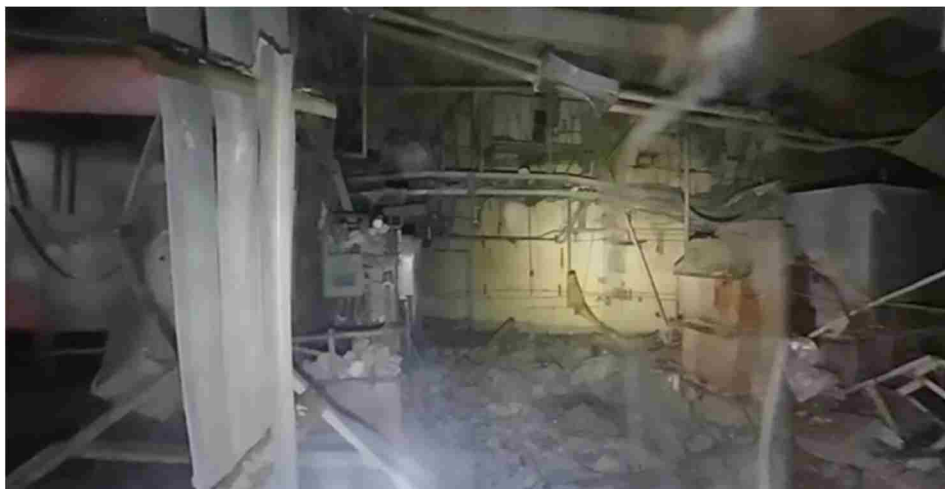
図2 3号機4階原子炉格納容器側の壁の状況（図1の写真①）
