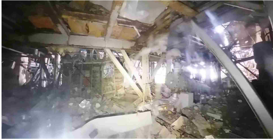
図4 4階に設置されている設備・ラックの状況（図1の写真②-1）
