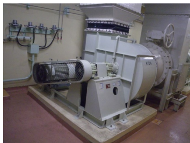
建家換気系排風機
