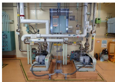
槽類換気系排風機
