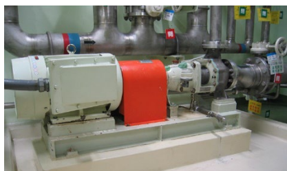
一次冷却水ポンプ
