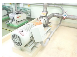
一次冷却水予備ポンプ
