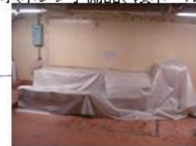
資材(ポンプ予備品、段ボール等)【防災シート】 資材(ポンプ予備品、段ボール等)【防災シート】
