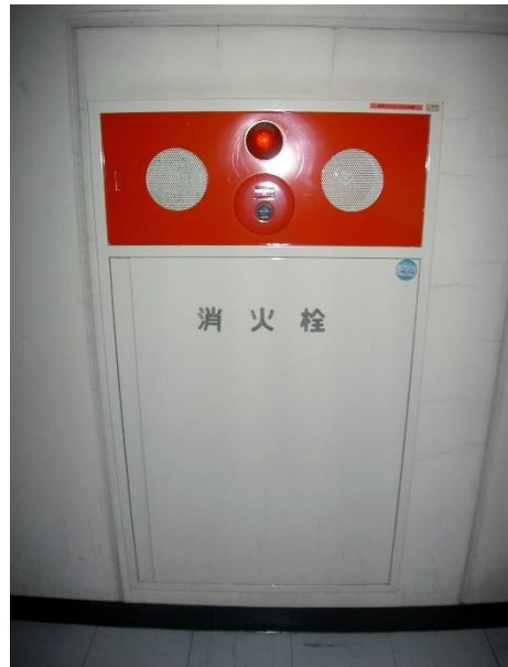
屋内消火栓 例
