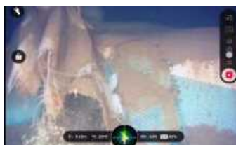
破損している土囊(現在)
